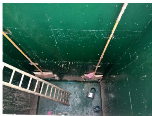
粗格栅防腐防渗
